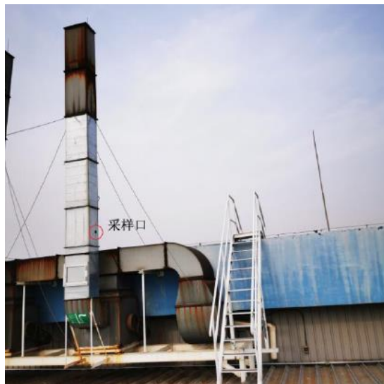
现有 DA005 排气筒
