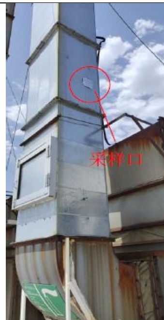
现有 DA005 排气筒采样口
