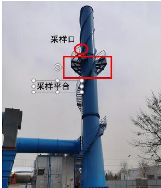
现有 DA007 排气筒
