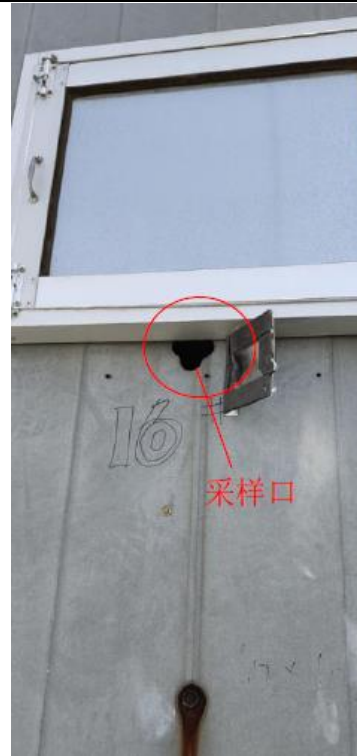
现有 DA004 排气筒采样口
