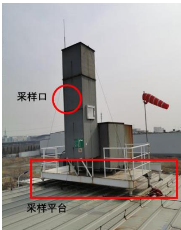
现有 DA004 排气筒
