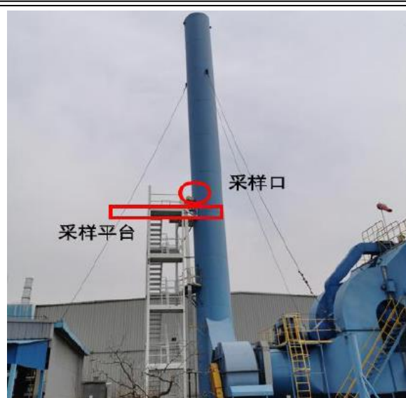
现有 DA006 排气筒
