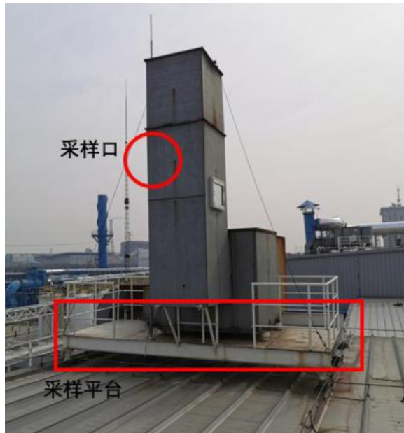
现有 DA002 排气筒
