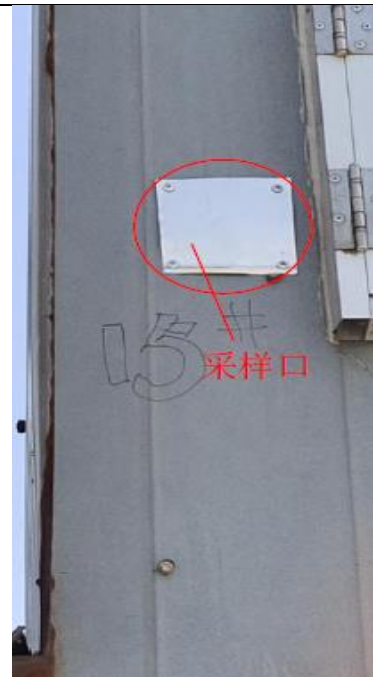
现有 DA003 排气筒采样口
