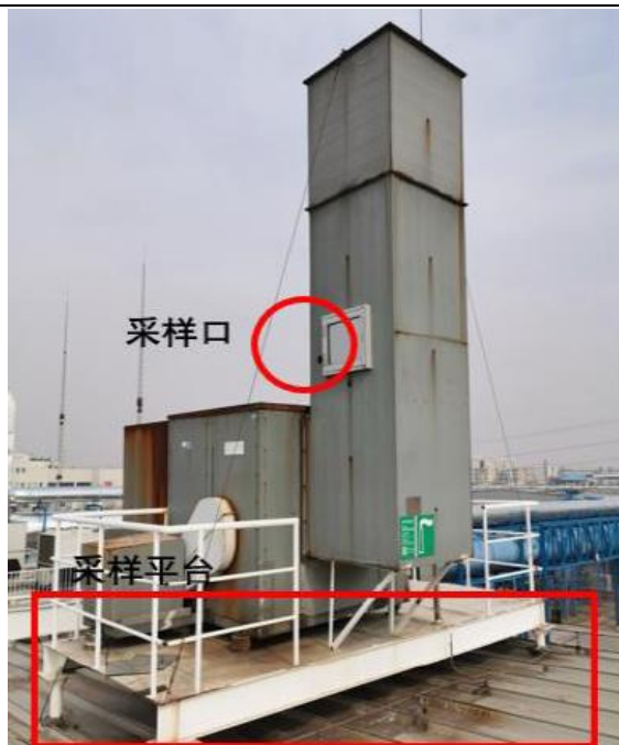
现有 DA003 排气筒
