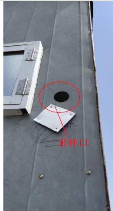
现有 DA002 排气筒采样口
