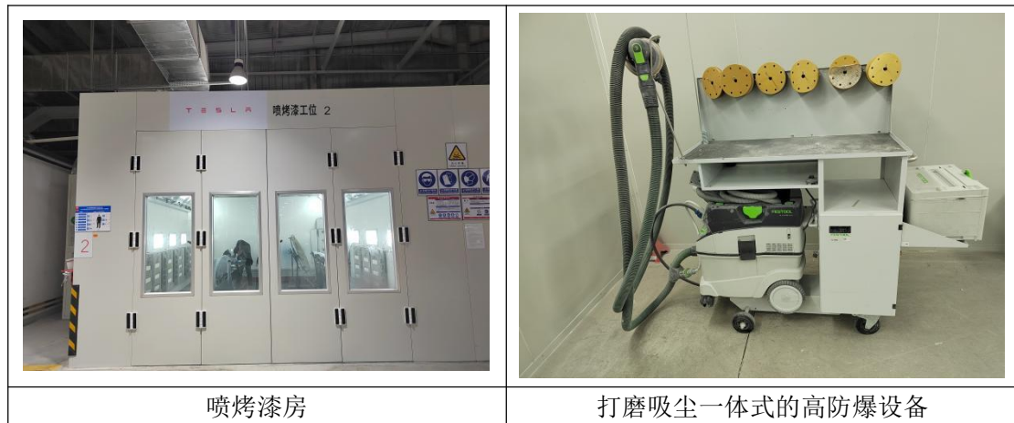
图 2-1 主要设备现场照片
