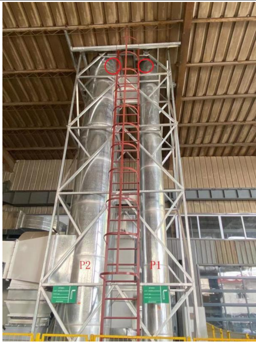
排气筒 P1、P2 采样口及标识牌
