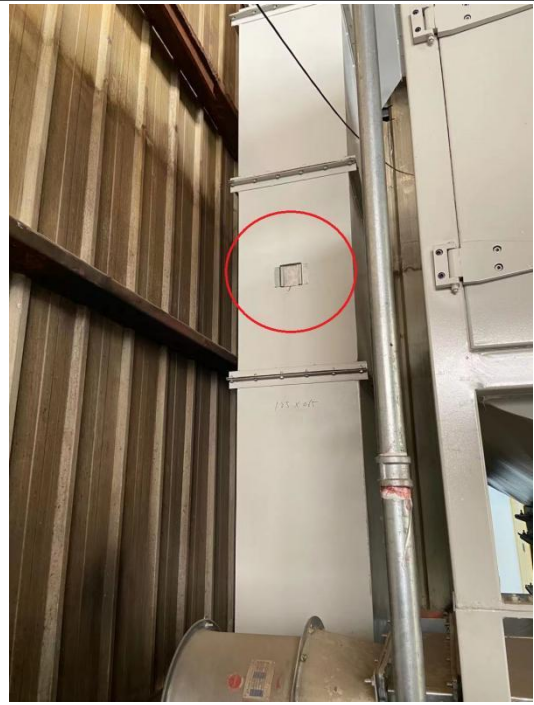
喷漆房废气入活性炭吸/脱附+催化燃烧装置进口
