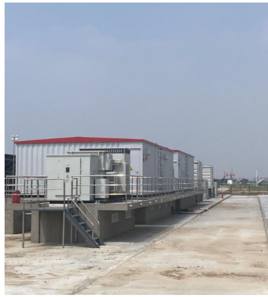
开闭站（地面硬化）
