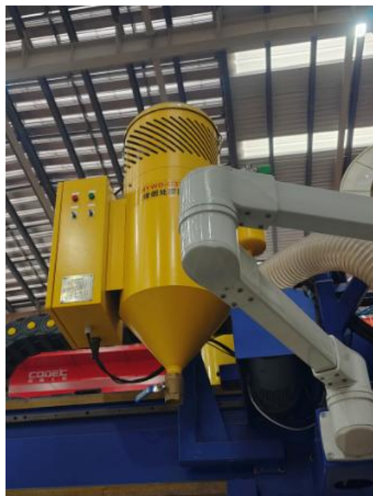
焊接烟尘处理设施
