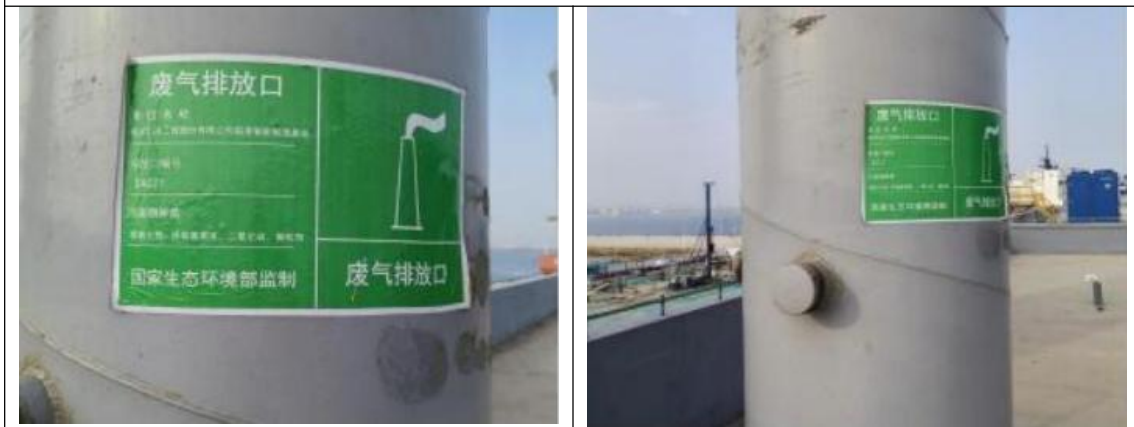
DA021 喷漆间冬季燃气废气排气筒（排放口标识牌、及采样口）
