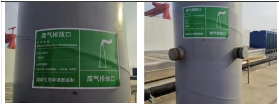
DA020 喷漆间冬季燃气废气排气筒（排放口标识牌、及采样口）
