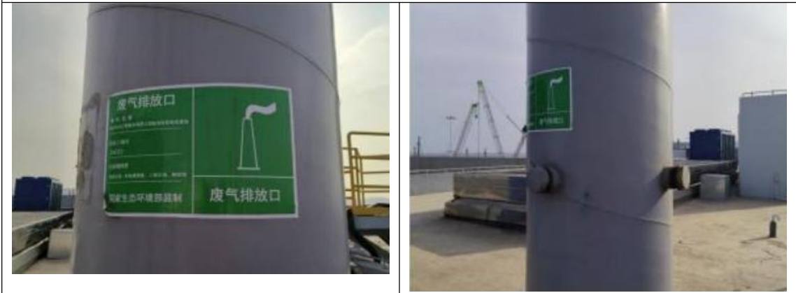
DA023 喷漆间冬季燃气废气排气筒（排放口标识牌、及采样口）
