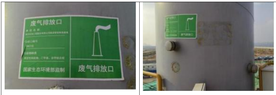
DA018 喷漆烘干废气排气筒（排放口标识牌、及采样口）
