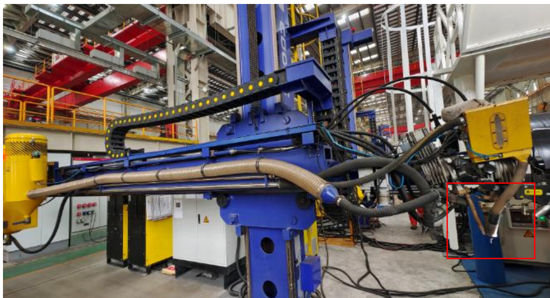
纵焊缝烟尘净化器收集端
