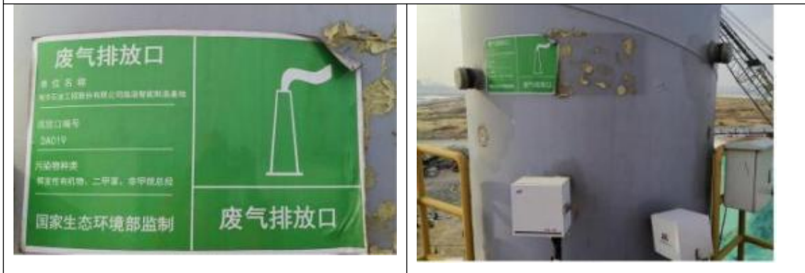
DA019 喷漆烘干废气排气筒（排放口标识牌、及采样口）
