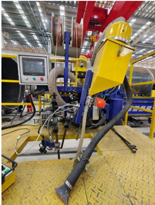
环缝焊接设备自带焊接烟尘净化器
