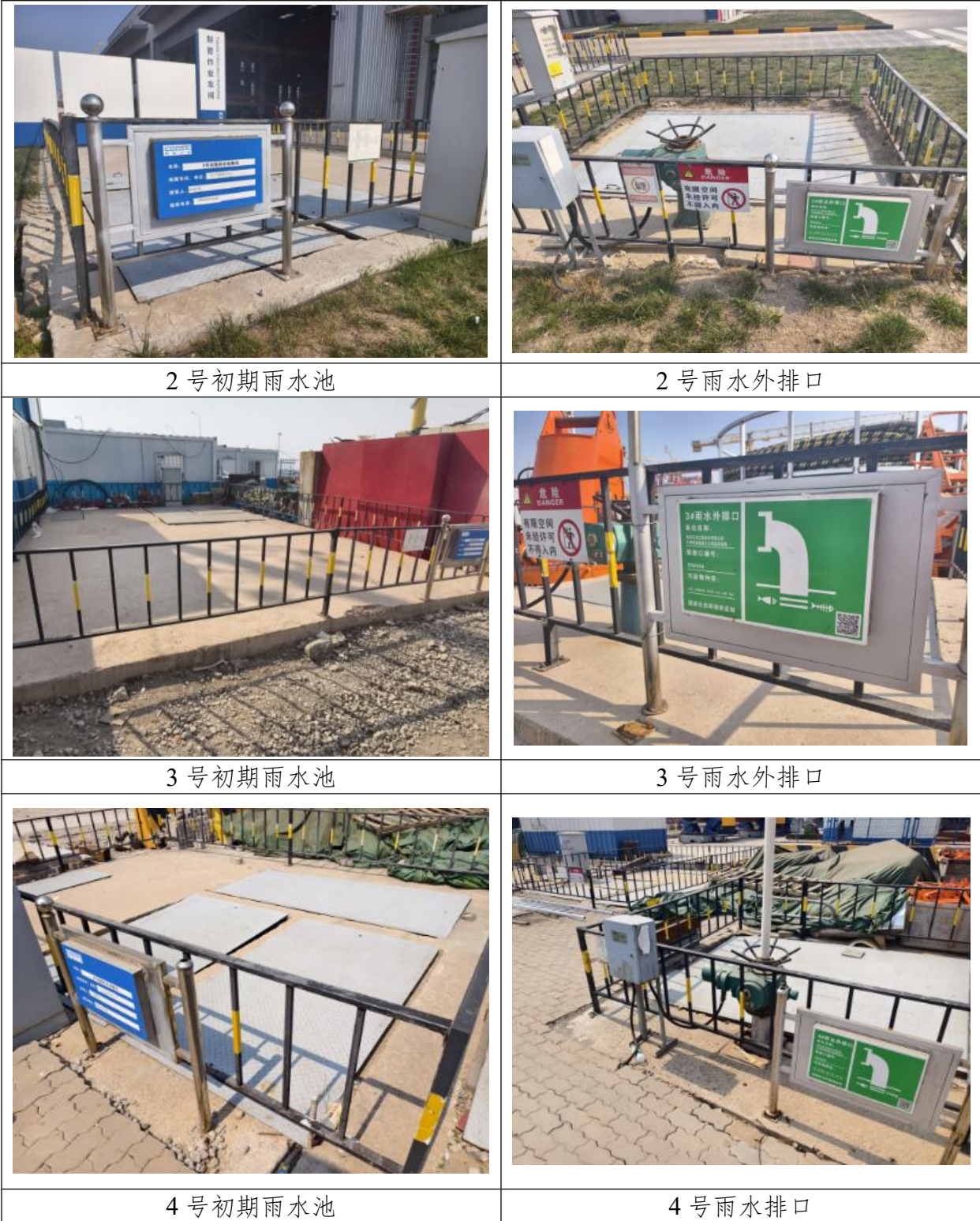
图 4.2-2 雨水池、事故水池及雨水排口闸阀
