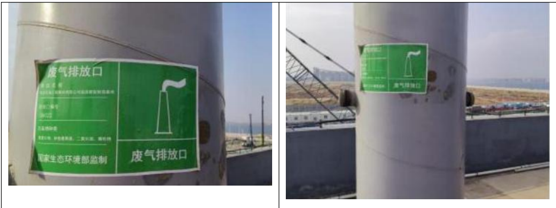
DA022 喷漆间冬季燃气废气排气筒（排放口标识牌、及采样口）
