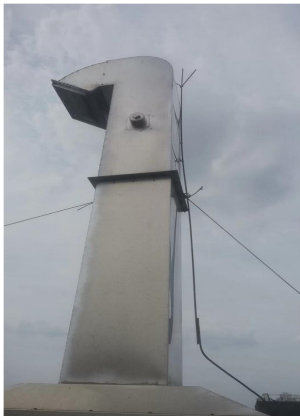
P1 排气筒采样口
