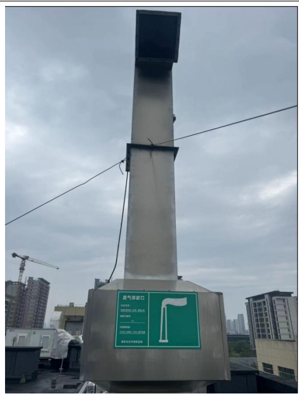
P1 排气筒标识牌
