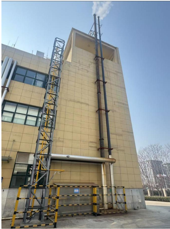
P2、P3 排气筒及采样平台
