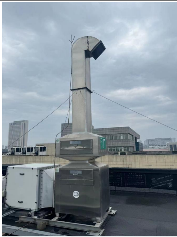
P1 排气筒及采样平台
