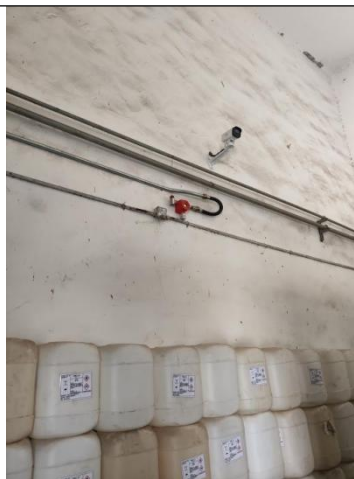
氨水暂存区设有气体探测仪和视频监控
