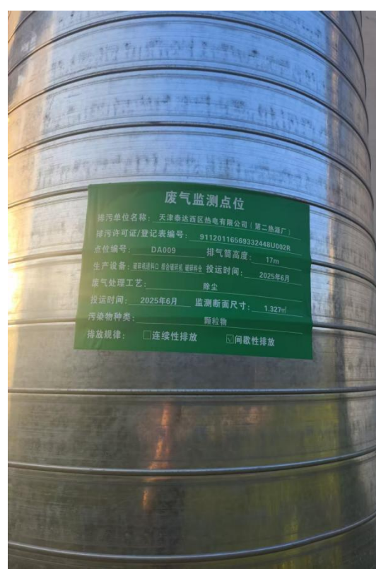
DA009 排气筒标识牌
