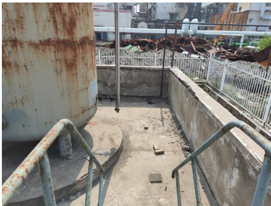
柴油储油罐区设有围堰
