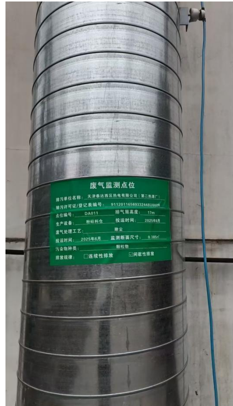
DA011 排气筒标识牌
