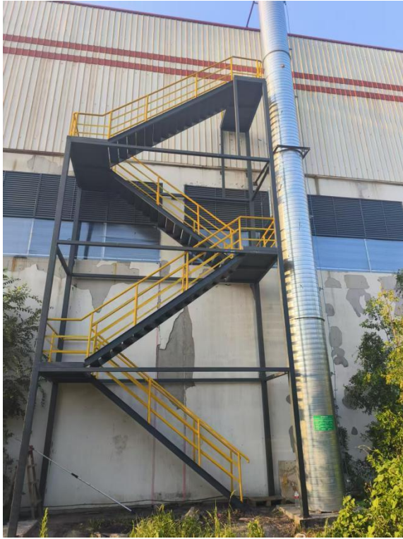
DA010 排气筒及采样平台
