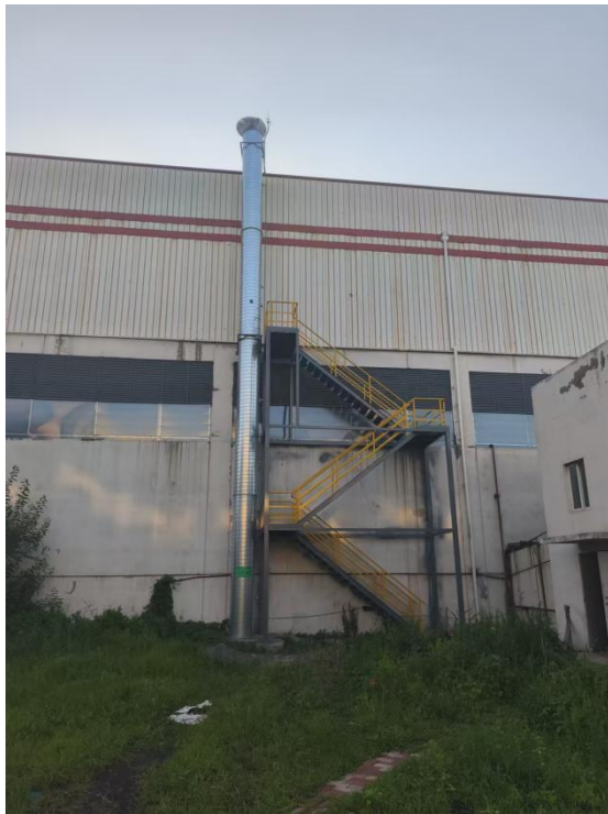
DA012 排气筒及采样平台
