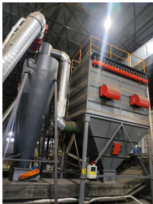
“旋风除尘+脉冲布袋除尘”处理设备
