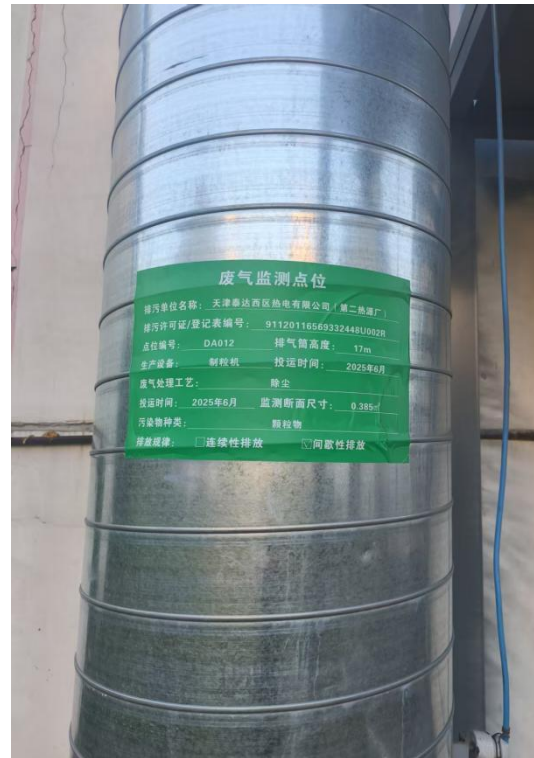
DA012 排气筒标识牌
