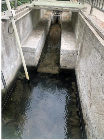
废水总排口 DW001
