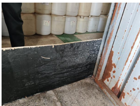
氨水暂存区设有边沟和围堰
