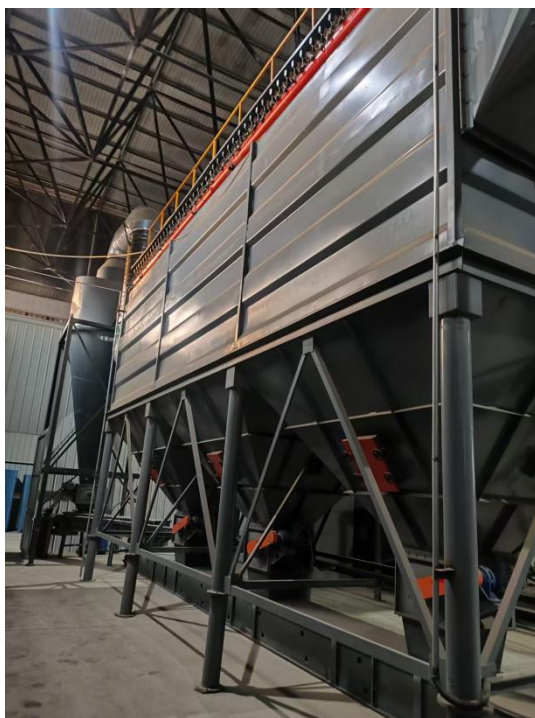
“旋风除尘+脉冲布袋除尘”处理设备
