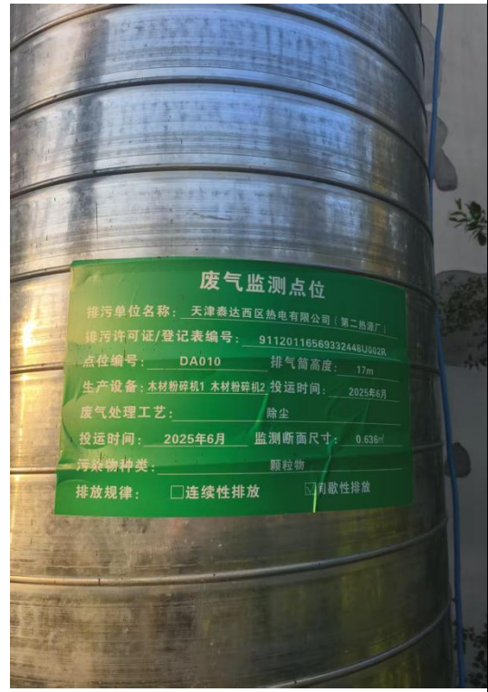
DA010 排气筒标识牌
