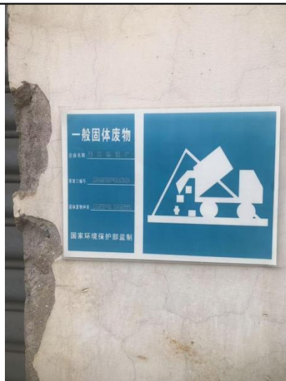
一般固废间标识牌
