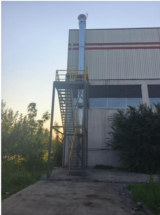
DA011 排气筒及采样平台
