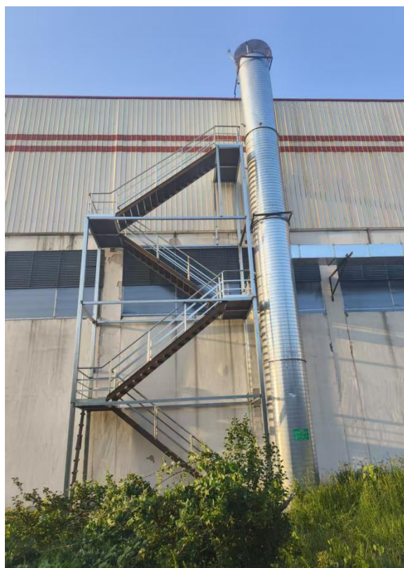
DA009 排气筒及采样平台
